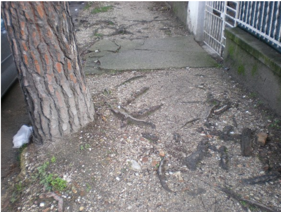
Via A Garibaldi: tratti di marciapiede e passi carrai divelti dalle radici
