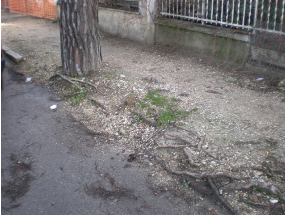
Via A Garibaldi: groviglio di radici in superficie che hanno demolito il cordolo del marciapiede
